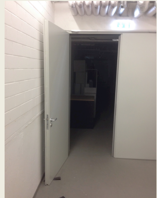
selbstschießende Tür blockiert (Im Brandfall verraucht der Rettungsweg)
